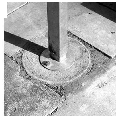
Besser ist die Verankerung ebenerdig auszuführen.
