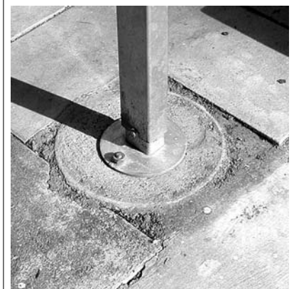
Besser ist die Verankerung ebenerdig auszuführen.
