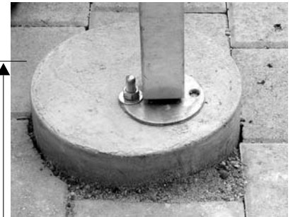
Verankerung auf überstehende Betonrohre, sieht nicht so schön aus.
