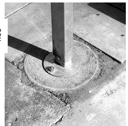
Besser ist die Verankerung ebenerdig auszuführen.
