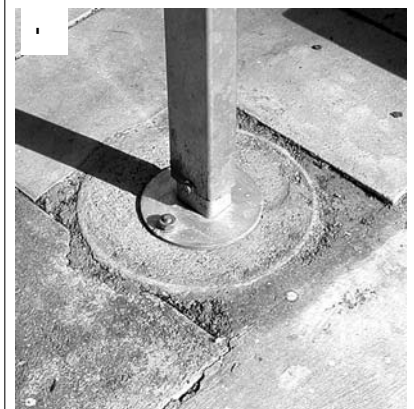
Besser ist die Verankerung ebenerdig auszuführen.
